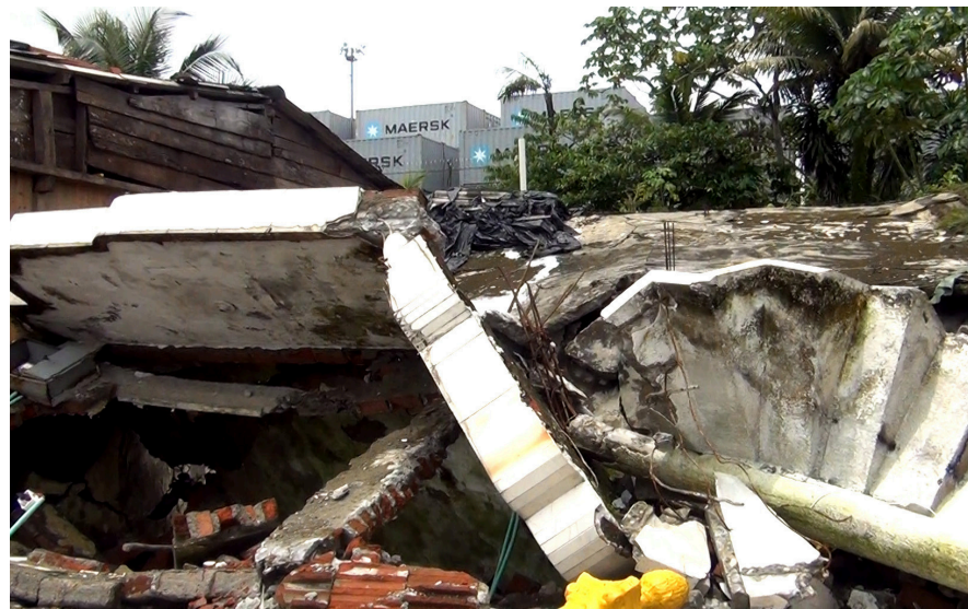
Cada de Don Alfonso, colapsada en Septiembre de 2015
